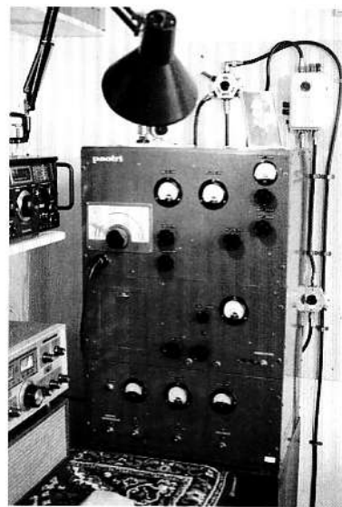
Afb. 13 De in 1952 gebouwde all-band zender is nog altijd bedrijfsklaar! Keurig nette etagebouw met v.b.n.o. zender, modulator met opbergkast voor de spoelen en voeding. Let op de antenne-bekabeling langs de muur! (red.)
