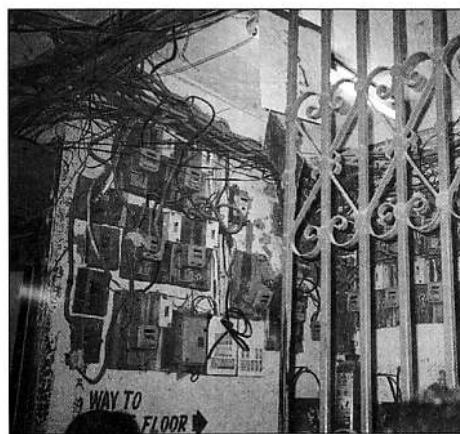
Stroom-verdeelkasten en elektriciteitsmeters in New Delhi! Waarom zou je het netjes doen als het ook zo kan? De pijl wijst de weg naar Floor, PAoFL, die daar mogelijk een appartementje heeft.
