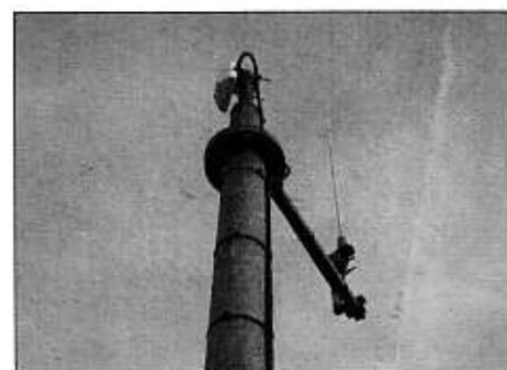
De tweede antennemast bevat de 2m-antenne voor APRS en de richtantenne voor 1,2 Mb naar PI1YDN/PI1YRC.
