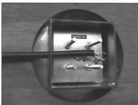
Een van de vier Switching Units direct onder de antenne. De middenaansluiting van de SO-239 plug zit in het midden op de print. De mantel van de coaxkabel komt niet in contact met de afscherming.
