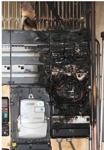
Brand in de meterkast, je moet er niet aan denken...
